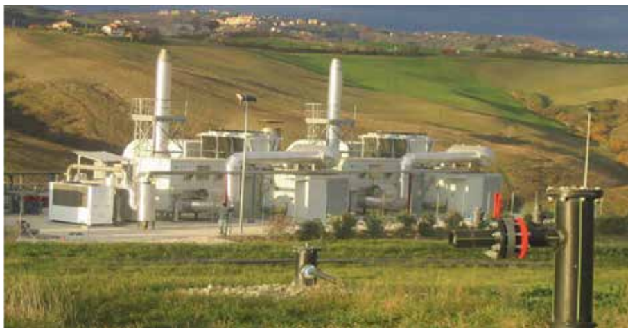
Figura 2.7 Centrale termoelettrica alimentata dal biogas di discarica
